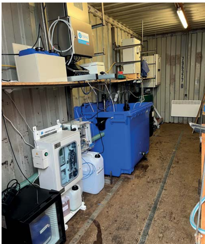
De meetopstelling in de container
