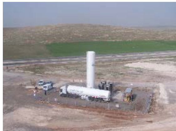
Figuur 9: LNG satellite plant Turkije
