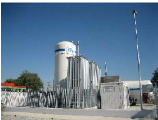
Figuur 8: LNG-tank Italië
