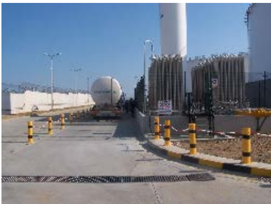
Figuur 8: LNG satellite plant Turkije
