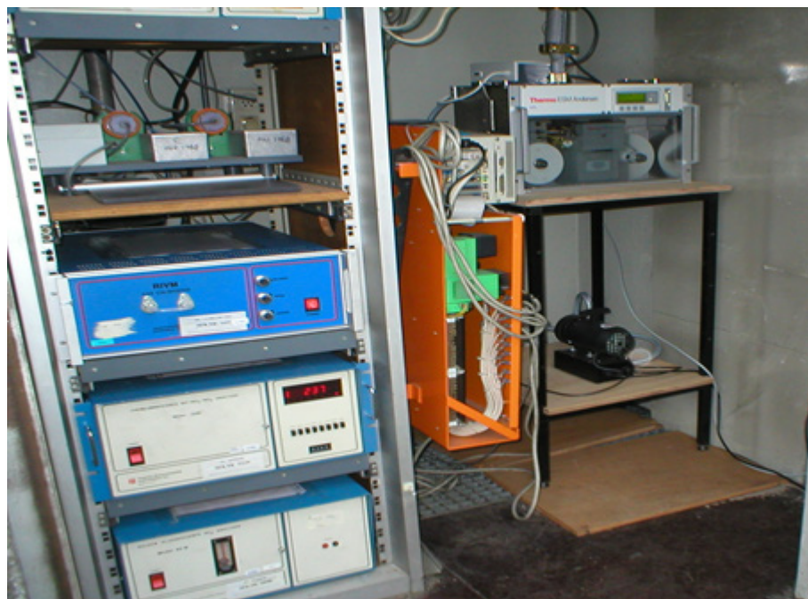
Afbeelding 5.7 Interieur van een meetstation voor luchtkwaliteit in het Landelijk Meetnet Luchtkwaliteit. Rechtsboven het meetapparaat voor fijn stof ( PM_{10} ) met randapparatuur. Links staan een aantal meetsystemen voor gasvormige luchtverontreiniging. Foto © D. van Straalen.
