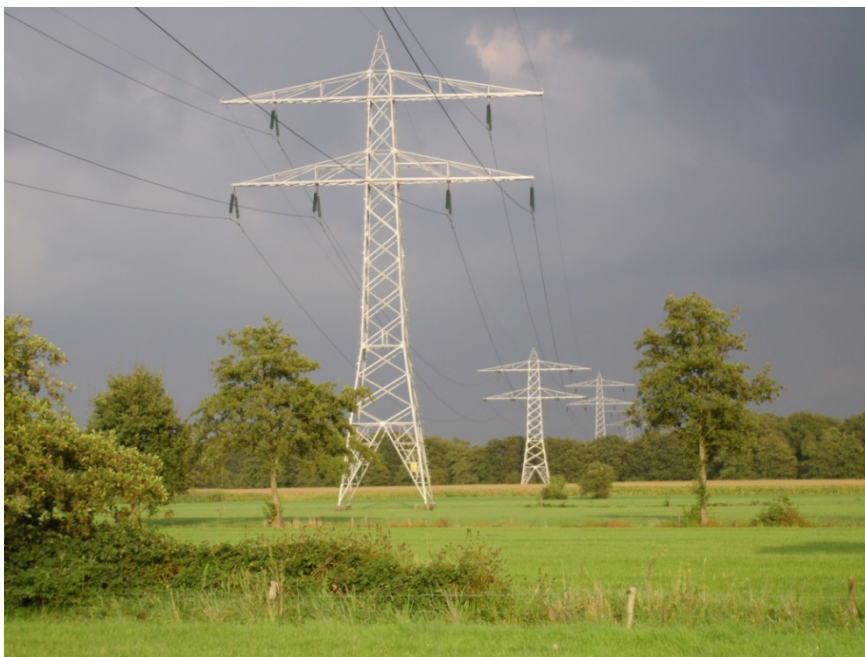
Figuur 2 Hoogspanningslijn Utrecht Lage Weide – Soest (locatie tussen mast 19 en mast 20, kijkend langs mast 20 in de richting van Soest)
